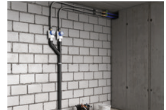
↑ PRIPÁJACIE POTRUBIE K ĎALŠIM ČASTIAM BUDOVY
