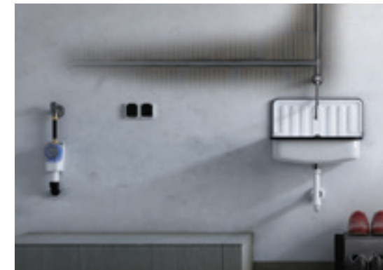
↑ NEVYUŽÍVANÉ VODOVODNÉ POTRUBIE
